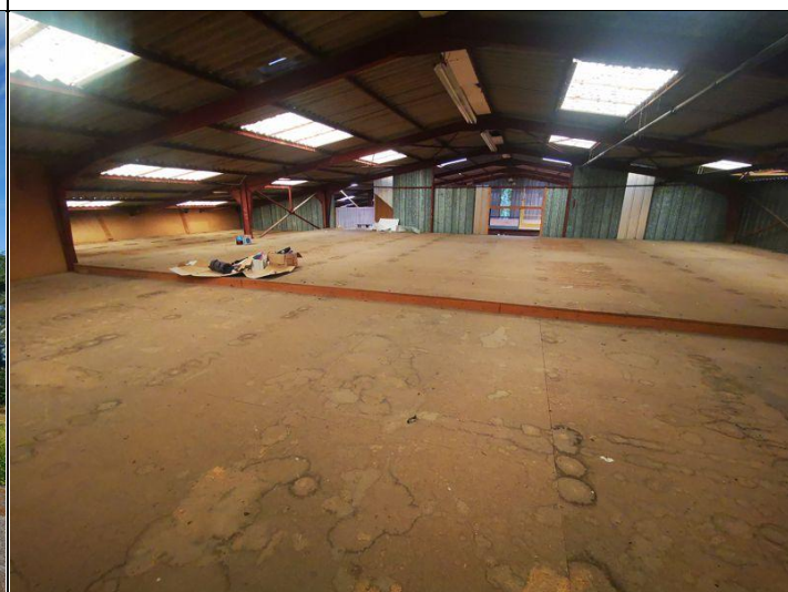
Photo 6 : Intérieur d'un bâtiment atelier abandonné.
