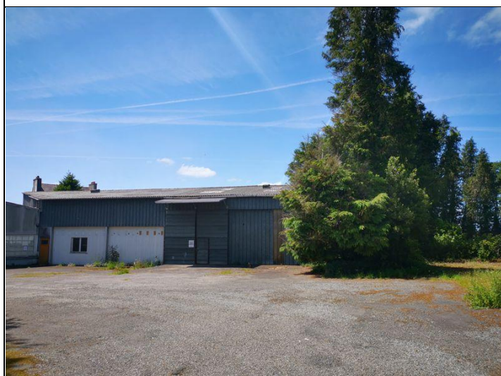
Photo 5 : Vue du grand atelier abandonné du site.
