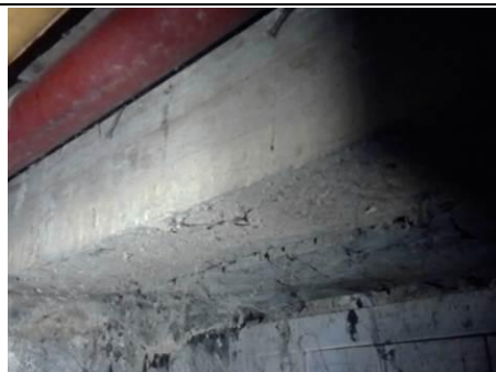
Photo n° PhTer008 Localisation : Sous-Sol - Cave Ouvrage : Linteaux Parasite : Anobium punctatum (Petites vrillettes) Indices : présence de trous de sortie, présence de vermoulure
