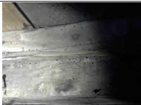
Photo n° PhTer007 Localisation : Sous-Sol - Cave Ouvrage : Plafond (poutres et parquet) Parasite : Anobium punctatum (Petites vrillettes), Xestobium rufovillosum (Grosses vrillettes) Indices : bois piqué, dégradation du bois, présence de trous de sortie, présence de vermoulure
