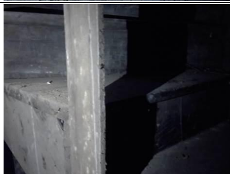
Photo n° PhTer009 Localisation : Sous-Sol - Cave Ouvrage : Escalier Parasite : Anobium punctatum (Petites vrillettes) Indices : présence de trous de sortie, présence de vermoulure
